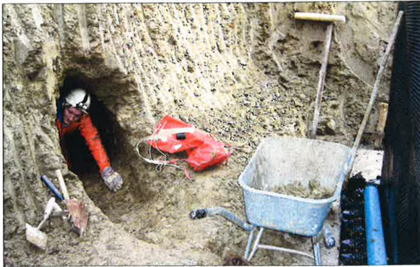
Bei Baggerarbeiten für das Fundament einer Wagenhütte (rechts) wurde ein unterirdischer Gang, der in den Hang hineinführt, angeschnitten.
